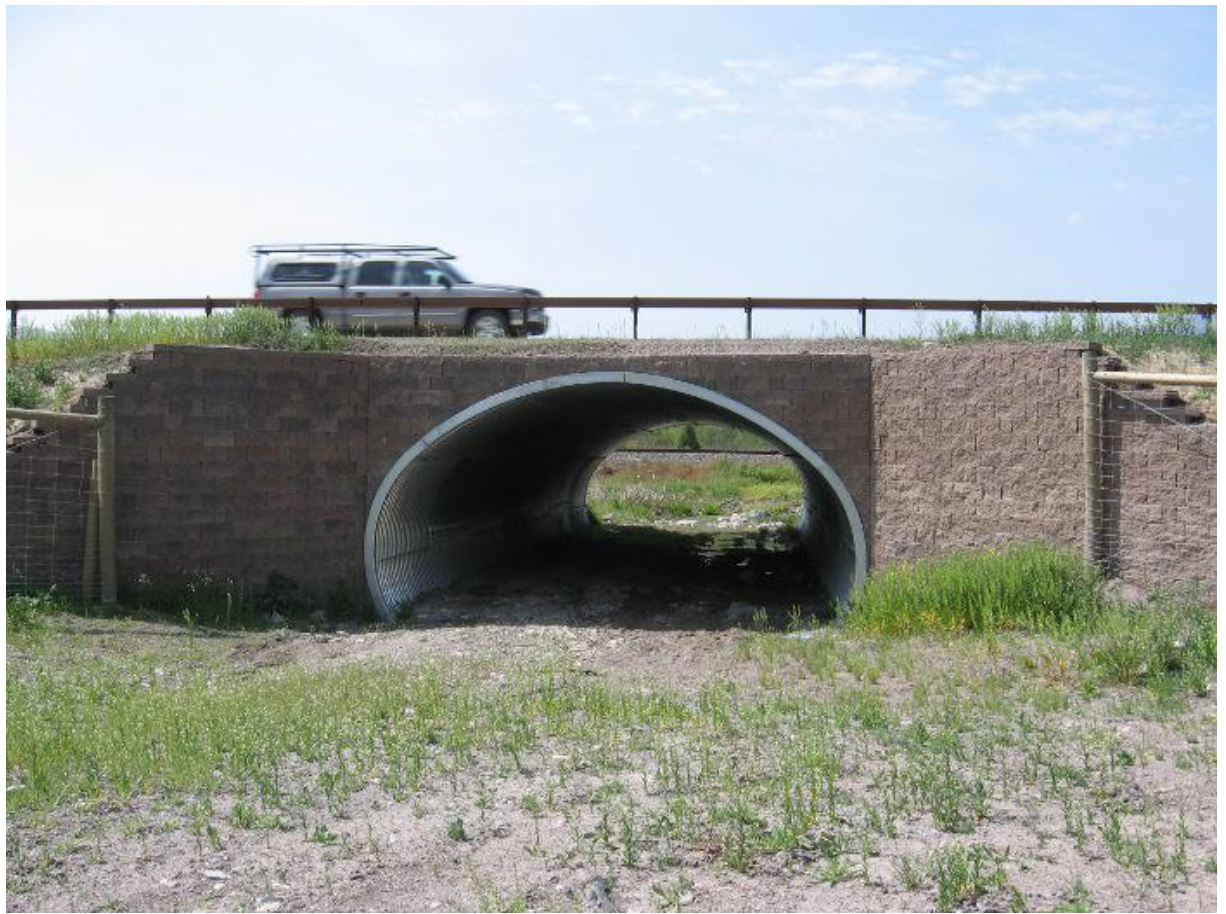
(Foto di M.Huijser: sottopasso per grandi mammiferi, 7-8 mt largo e 4-5 mt alto. Highway 93, Flathead Riserva, Montana, U.S.A.)
