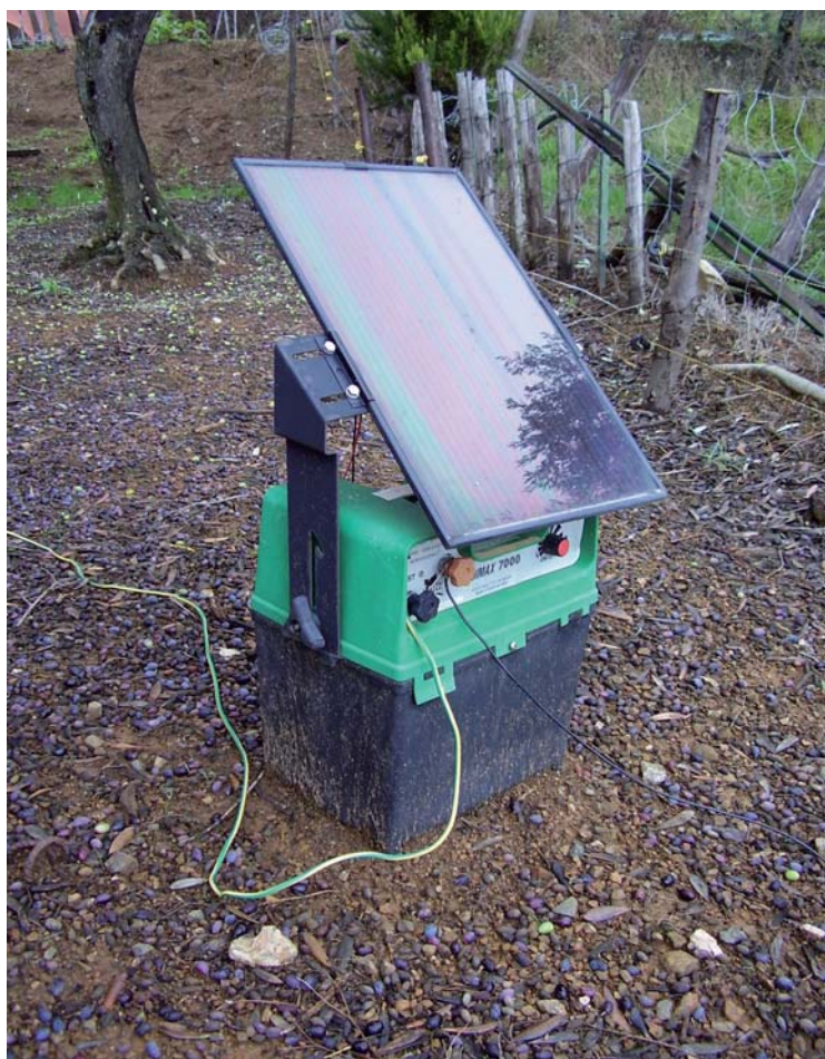
Figura 7.5 - Esempio elettrificatore alimentato mediante pannello solare (Foto A. Monaco).
