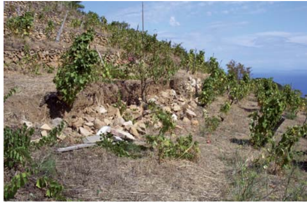
Figura 3.9 - Muro a secco di un vigneto terrazzato abbattuto. (Foto F. Giannini).
