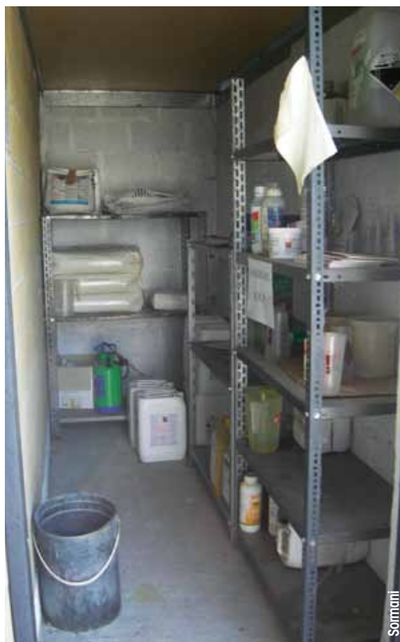
Deposito correttamente realizzato per lo stoccaggio dei prodotti fitosanitari
