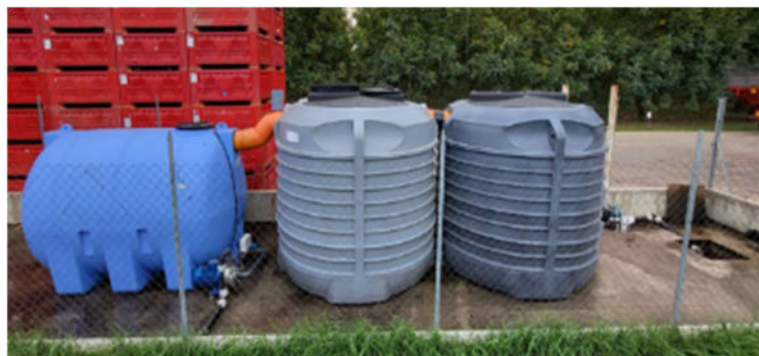
Da destra a sinistra: dissabbiatore, degrassatore e accumulo con pompa esterna di pressurizzazione del fitro autopulente
