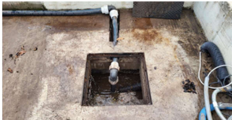
Pozzetto di sollevamento con pompa sommersa
