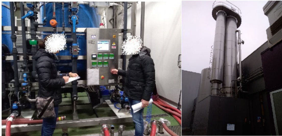
Figura 4.2. Incontro Tecnico e Visita Guidata, tenutisi in data 20 Novembre 2019 presso lo stabilimento di TERRE CEVICO, a Lugo (RA), dove è ubicato l'impianto di rettifica e concentrazione innovativo.
