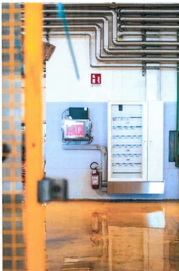
Figura 3.2.8. Panelli di controllo.
