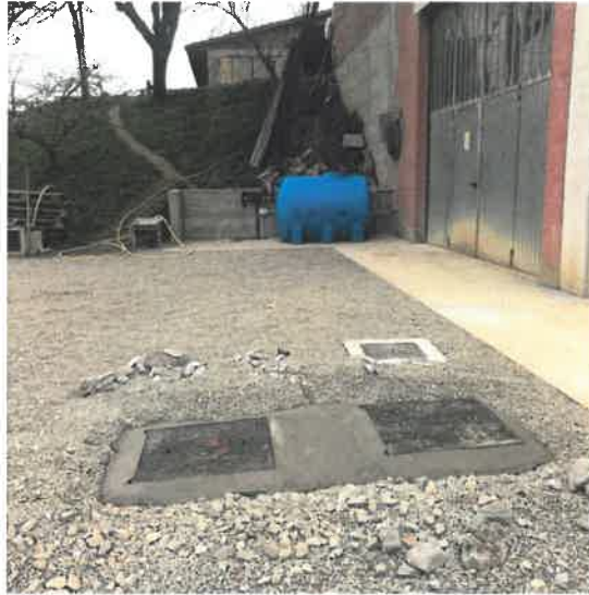
Figura 3.2.4. Pozzetti con pompe di recupero acque da piazzola - distinte acque pulite e acque sporche.
