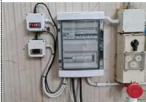
Sistema di gestione temperatura umidità e registrazione.
