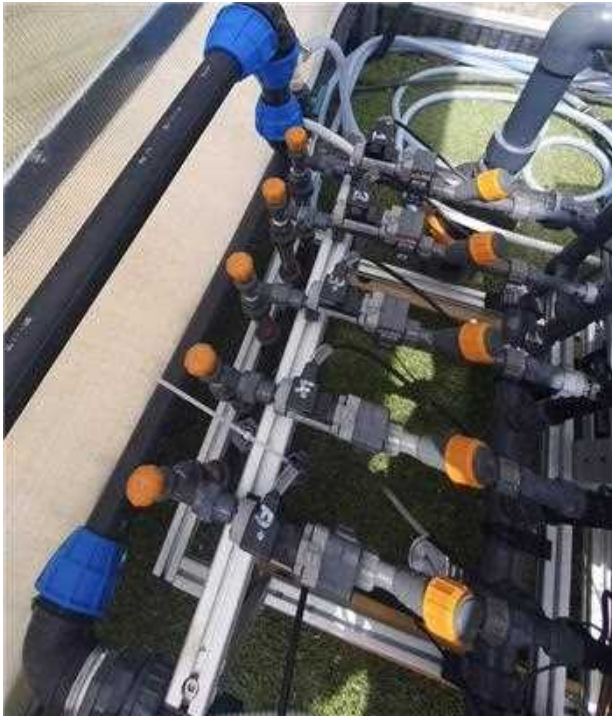
Figura 7 Particolare delle linee dedicate alla fertirrigazione
