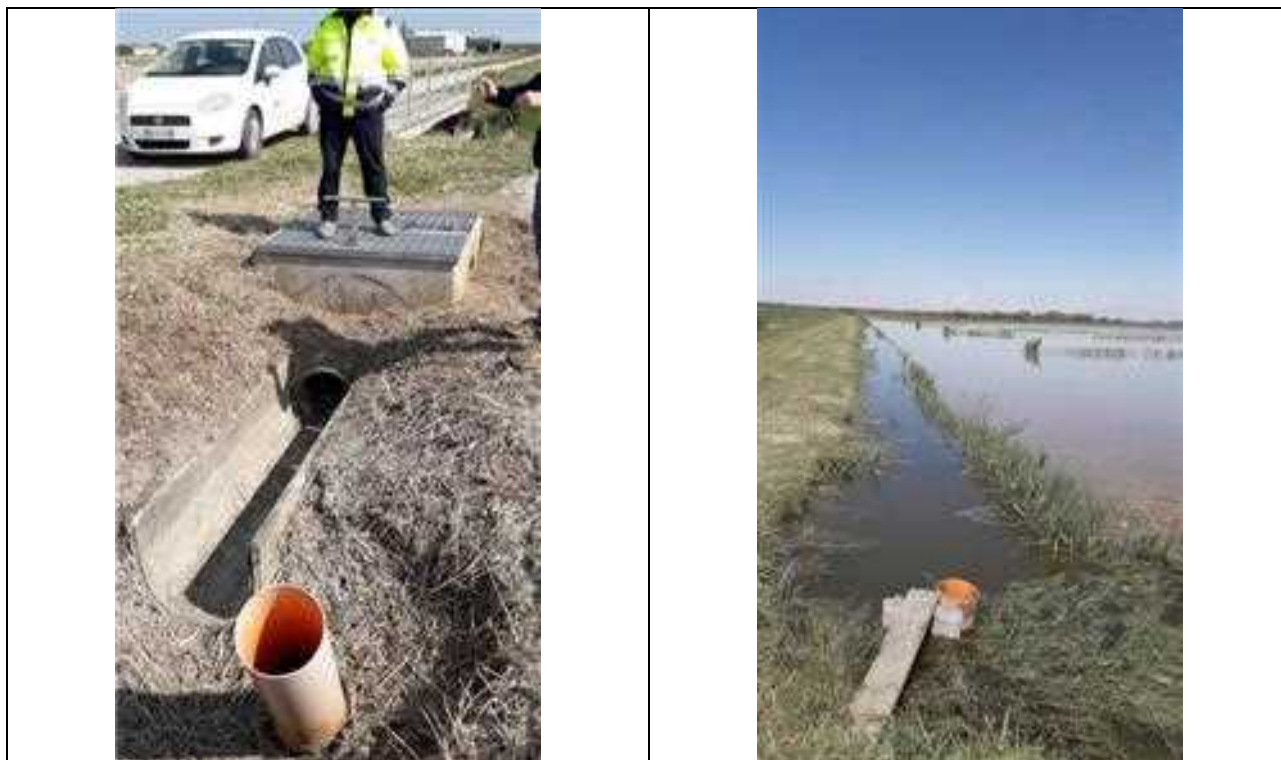
Figura 2: A sinistra: punto di immissione delle acque in risaia (IN); a destra: punto di uscita con sifone regolabile in altezza (OUT).
