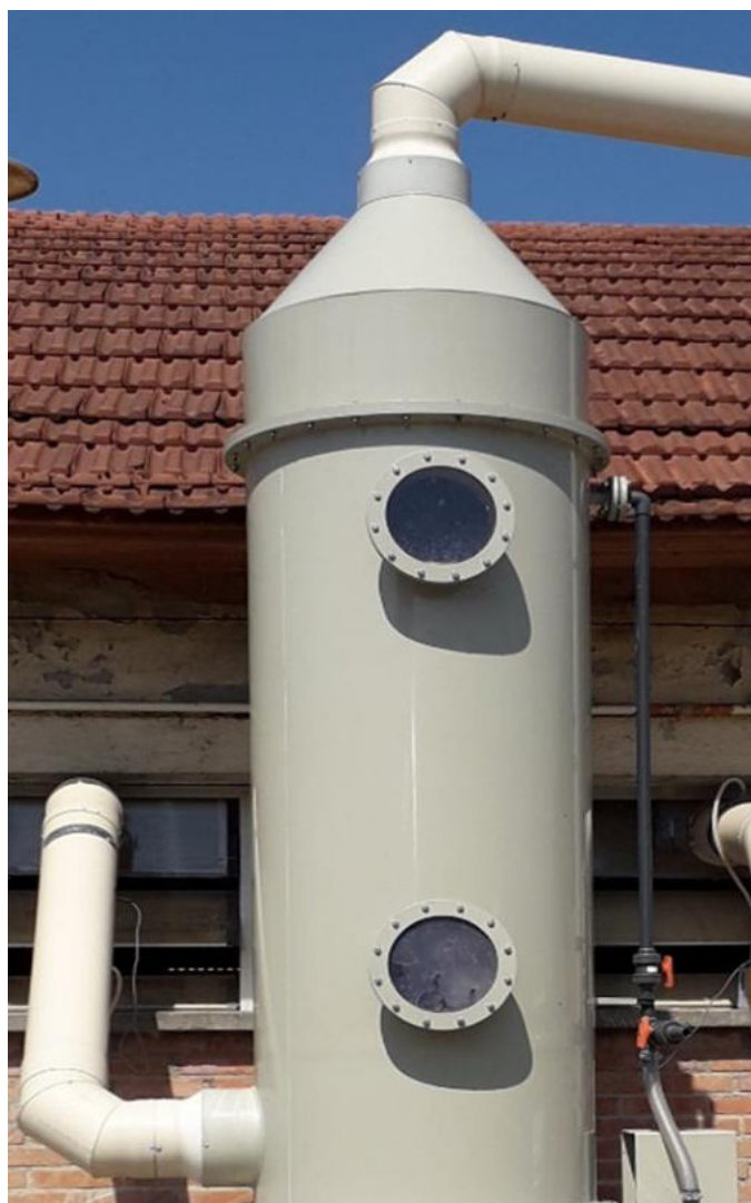
Figura 2 - Primo piano del prototipo installato: si notano gli oblò per verificare il corretto lavaggio e per permettere la manutenzione agli ugelli; i condotti che prelevano l'aria dalle sale della porcilaia
