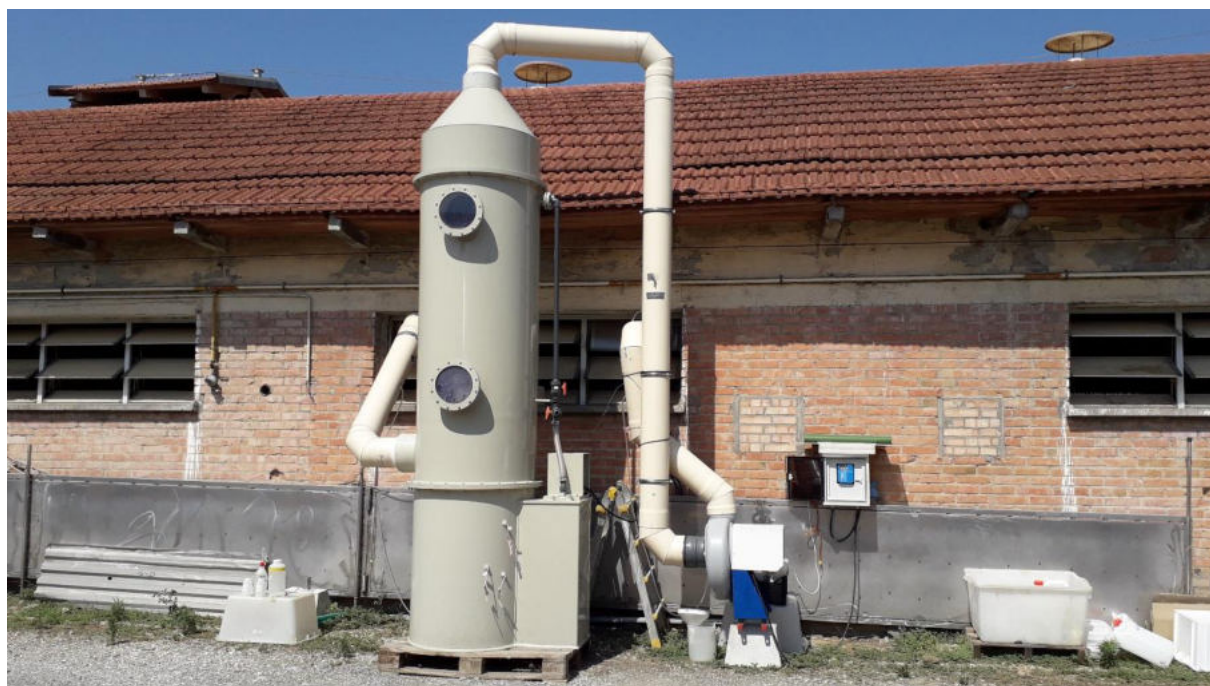
Figura 3 - Installazione del prototipo di trattamento presso l'allevamento Colombaro (2019)
