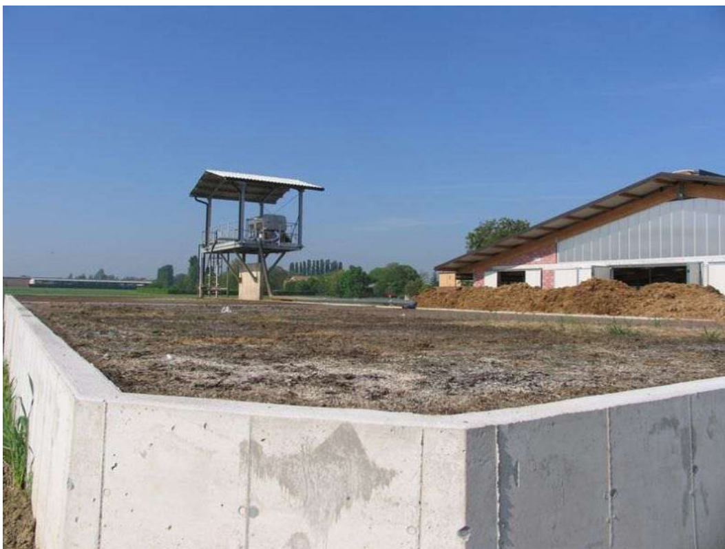
Figura 4.14 – Azienda C: opere per lo stoccaggio degli effluenti
