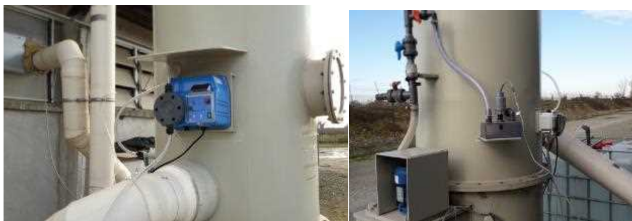
Figura 6.1.5 – Pompa dosatrice dell'acido (foto a sinistra) e sistema di misura del pH (foto a destra).
