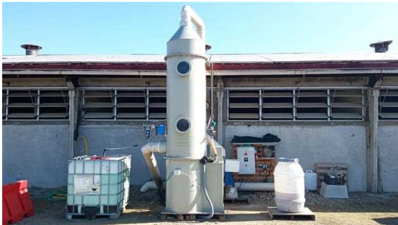
Figura 6.1.4 – Sistema di trattamento a regime ed in funzione.
