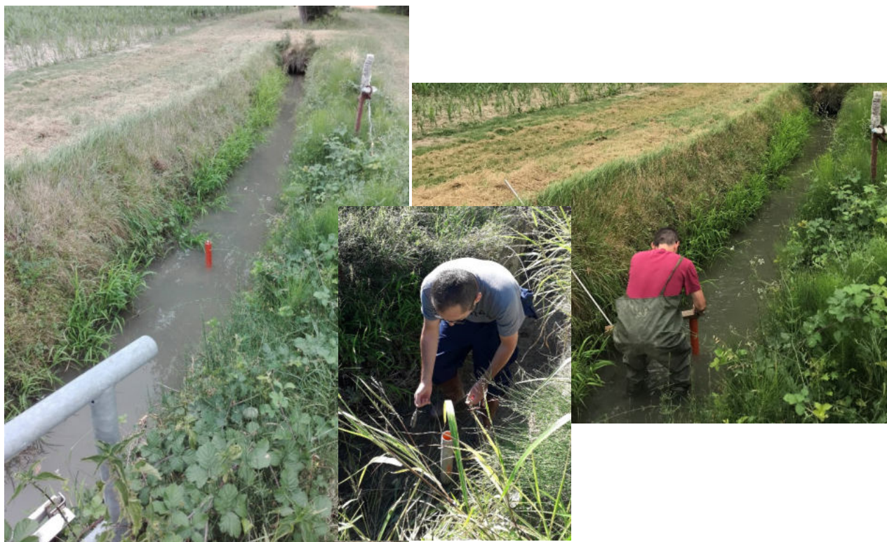
Figura 7: foto dell'installazione dei sensori di pressione e del recupero degli stessi presso punto C e D del tracciato del Canale Venenta
